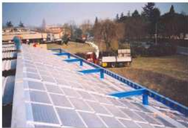
Fonte: Comune di Nova. Impianto Fotovoltaico presso la palestra comunale di via Bionta
